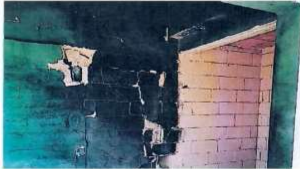
CELLAMARE Un'altra foto della deflagrazione agli spogliatoi dell'impianto sportivo cittadino verificatasi nella notte tra il 6 e il 7 gennaio
